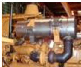
Brak dylatacji, izolacji drgań i amortyzatorów → nieuniknione pęknięcie
